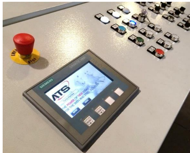
Figure 1 & 2 – TMB400 e quadro elettrico progettato da ATS.
